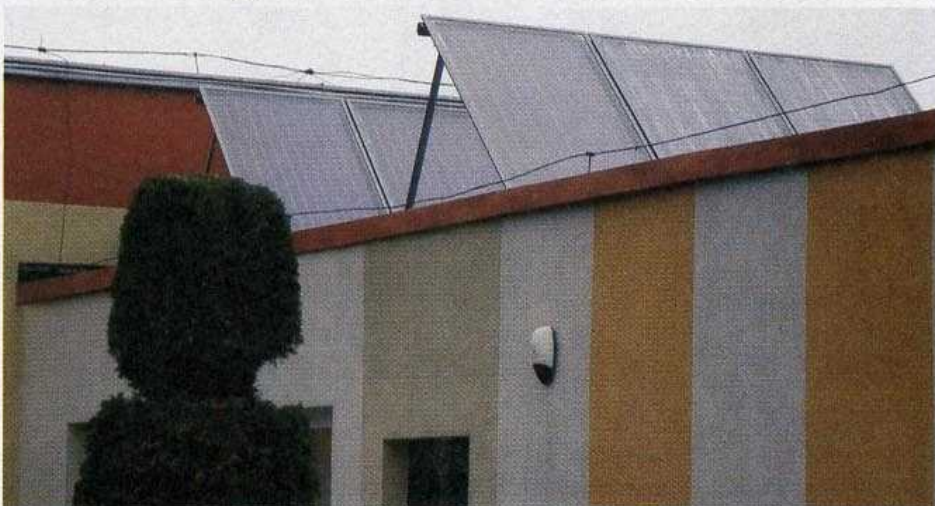
Układ solarny, który został zamontowany na dachu budynku, w którym mieści się m.in. Administracja naszej Spółdzielni przy ulicy 1 Maja.
